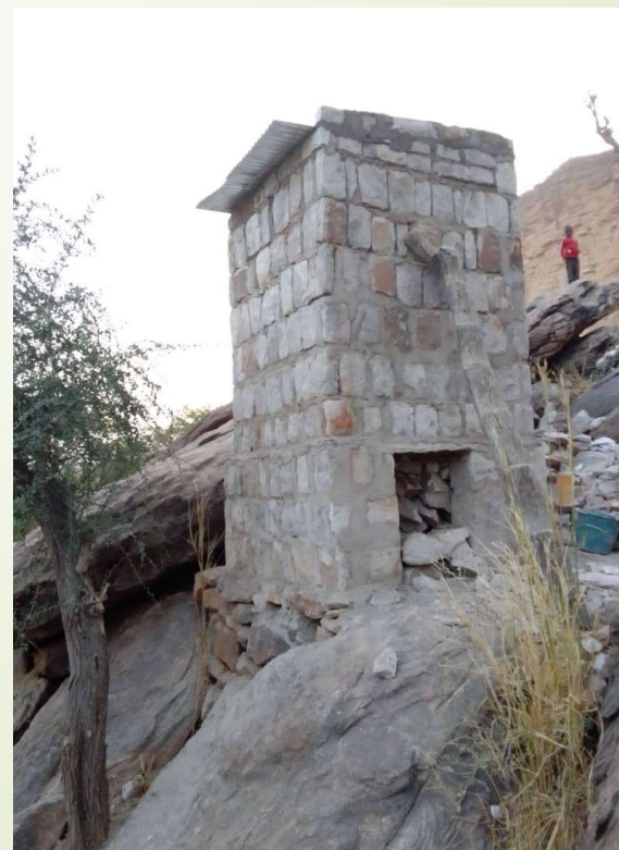
Les 2 latrines de Banani Amou
